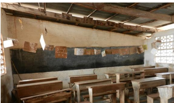
Binnenin: de daken zijn versleten, de muren moeten opgehoogd
