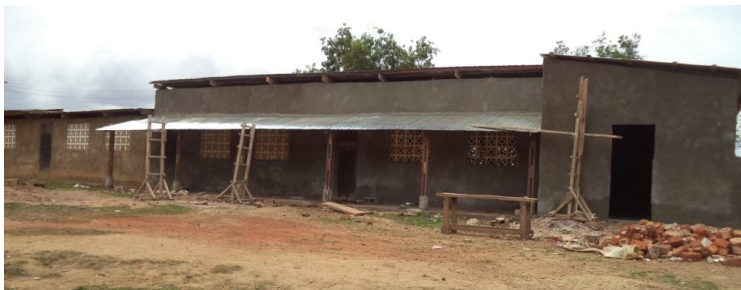
Situatie op 2 oktober 2016. Het is de bedoeling om in een later stadium stapsgewijs ook de overige klaslokalen op diezelfde wijze te verbouwen. Hiervoor is echter nog geen timing bepaald.
